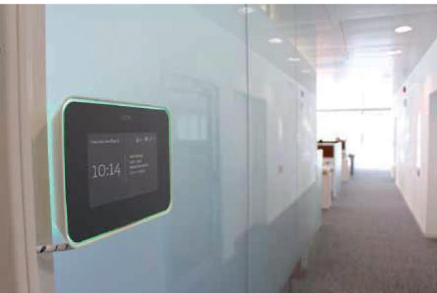
Tutte le informazioni relative a ciascuna sala, sono condivise in rete e gestibili da remoto.
